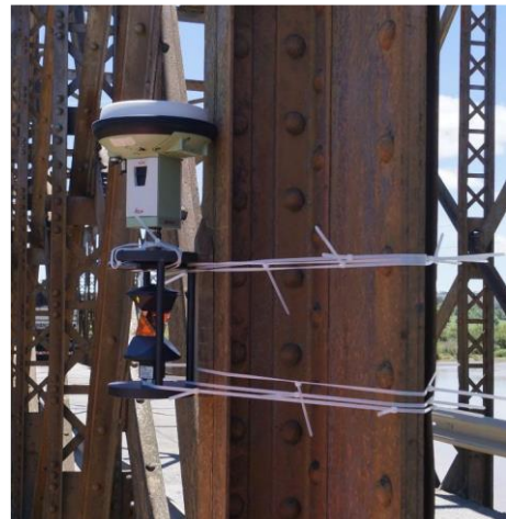
Figura 6 - Fixação dos sensores.
